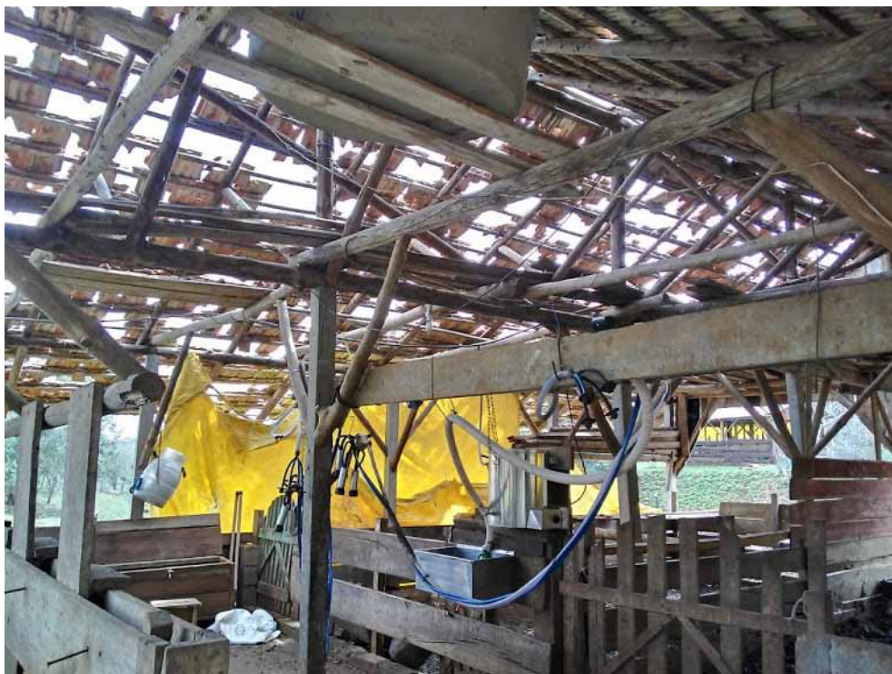
Figura 11. Destruição causada em instalação para bovinos – sala de ordenha: município de Vargem Bonita
